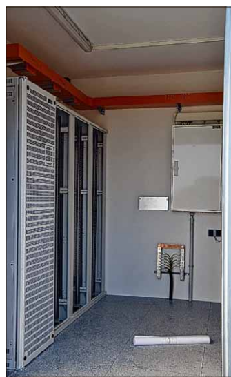
So sieht das Innere der Station aktuell aus.
